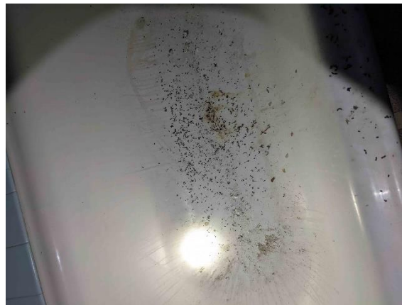
Guano dans bâtiment n°16
