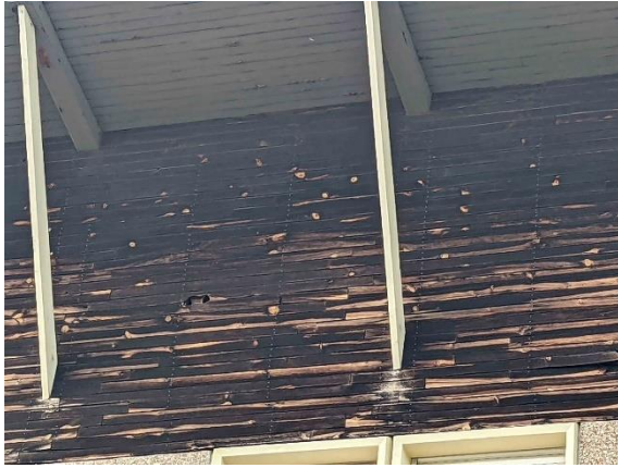
Trou dans le bardage du bâtiment n°13
